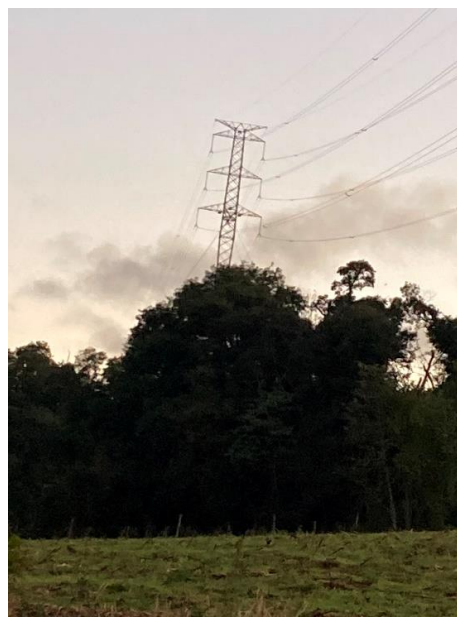
Figure 126. A LT 230 KV, Abdon Batista- Videira C1 e C2-CD. Concluída e em funcionamento. A imagem representa as linhas de transmissão na comunidade de Aparecida, no interior do município de Videira. Na divisa com o município de Tangará, onde está localizada a escola Zumer, no Passo da Felicidade. No estado de Santa Catarina, Brasil.
